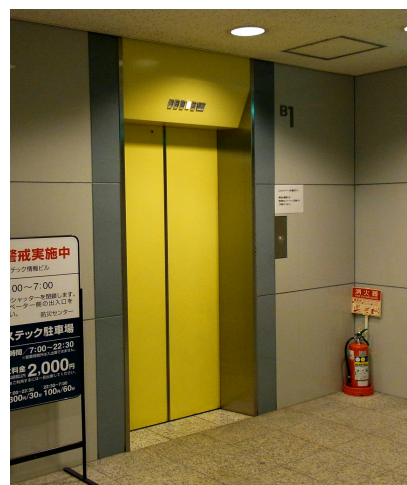
駐車場用エレベーター
