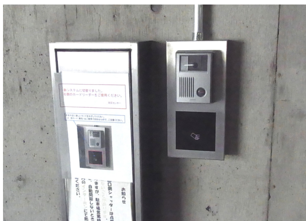
駐車場シャッターの開閉装置
