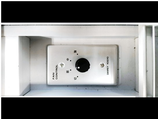
東側空調ファンコイルユニット（調整操作部分）
