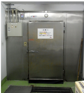
生ゴミ用冷蔵室
