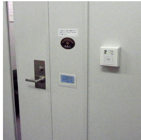
ドア横に設置されたカードリーダー
