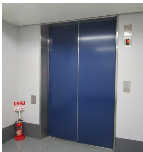
非常・荷物用エレベーター
