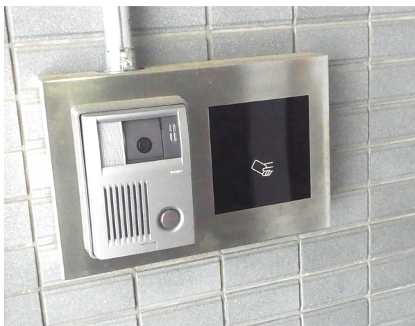
C出入口（外側）のICカードリーダー
