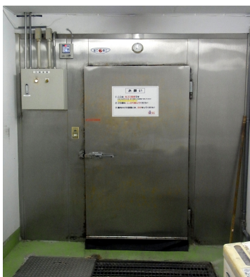
生ゴミ用冷蔵室
