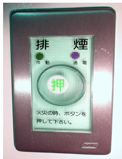
排煙装置 起動ボタン
